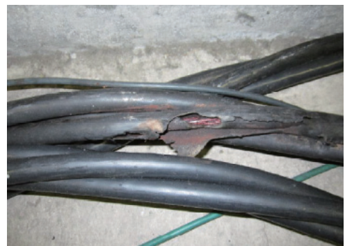
写真1 絶縁破壊したケーブル
