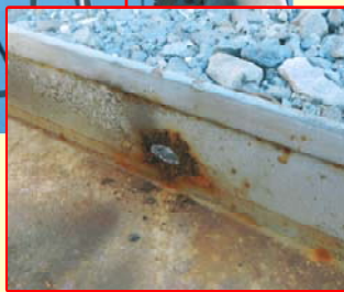
底板側面の錆貫通穴
