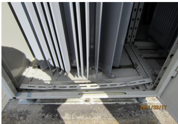
←(茨城県石岡市)【震度6弱地域】 ・商業ビル(6kV受電120kW屋内2階キュービクル) ・地震動により変圧器取付ベース及び固定用チャンネルが破損。変圧器が傾斜し高圧絶縁電線(KIP)が破断
