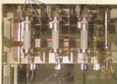
高圧絶縁電線 PF・S形の主遮断装置 （限流ヒューズ付き高圧交流負荷開閉器）
